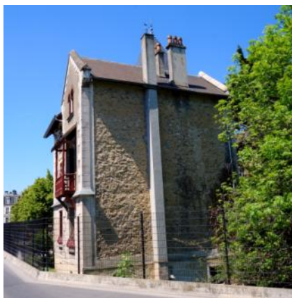
La Villa Max avant les travaux 2019, avec le balcon sud et le conduit de fumées à démolir
